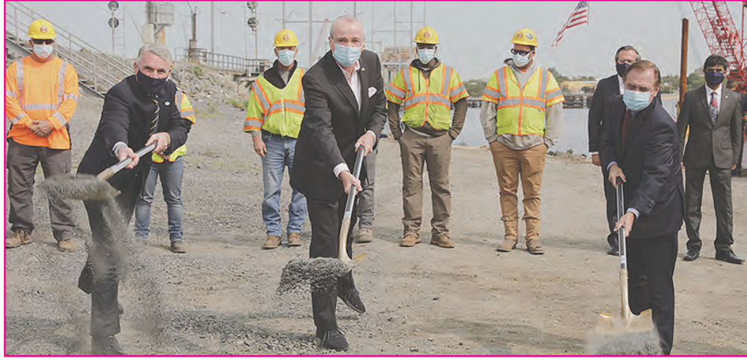
En la ceremonia de la “Primera Piedra” (Groundbreaking) que da inicio a la construcción del nuevo High School vemos al gobernador Phil Murphy, vocero de la Asamblea, Craig Coughlin; el director ejecutivo de la Autoridad de Desarrollo Escolar de New Jersey (SDA), Manuel Da Silva; el superintendente de Escuelas Públicas de Perth Amboy, Dr. David Roman, entre otros.
